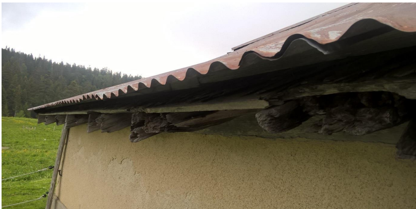
Figure 2 - Lazaret, absence de larmier et de chéneau
