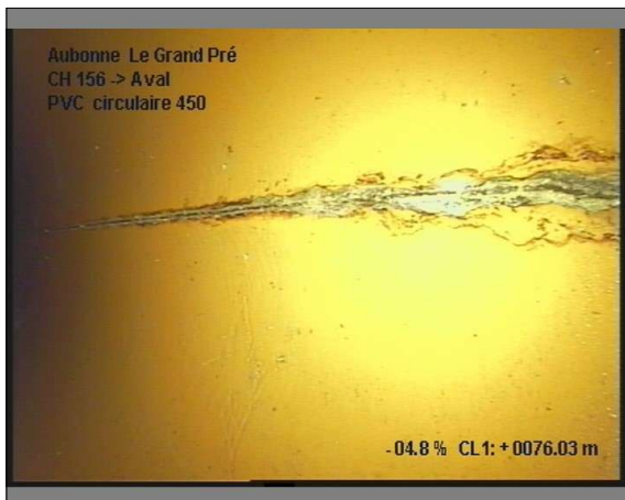
Photo: 1_21A, 00:09:44 76m, Fissure(s) à 12 h., Début du dommage
