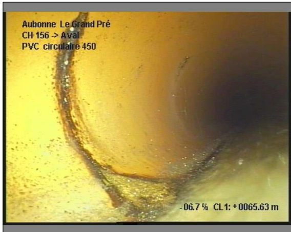
Photo: 1_18A, 00:08:24 65,6m, Liaison du tuyau non étanche de 12 à 12 h.
