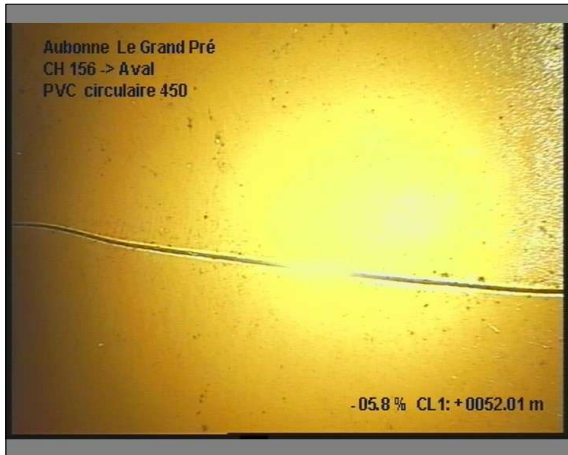
Photo: 1_13A, 00:06:27 52m, Fissure(s) à 12 h., Début du dommage
