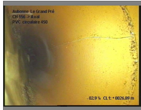
Photo: 1_4B, 00:02:34 26,7m, Etat général, selon photo
