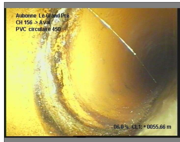
Photo: 1_15A, 00:07:01 55,6m, Liaison du tuyau non étanche de 12 à 12 h.
