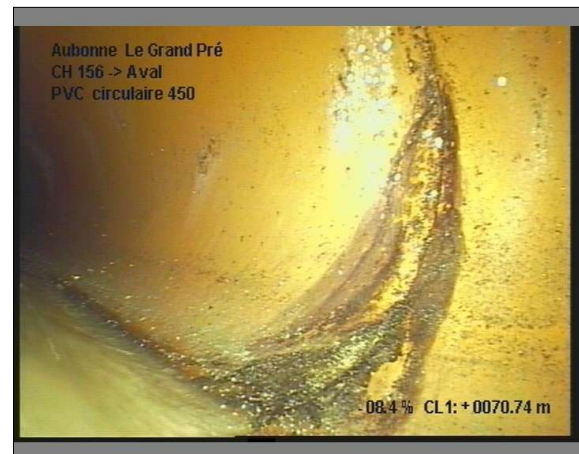
Photo: 1_19B, 00:09:00 70,5m, Liaison du tuyau non étanche de 12 à 12 h.
