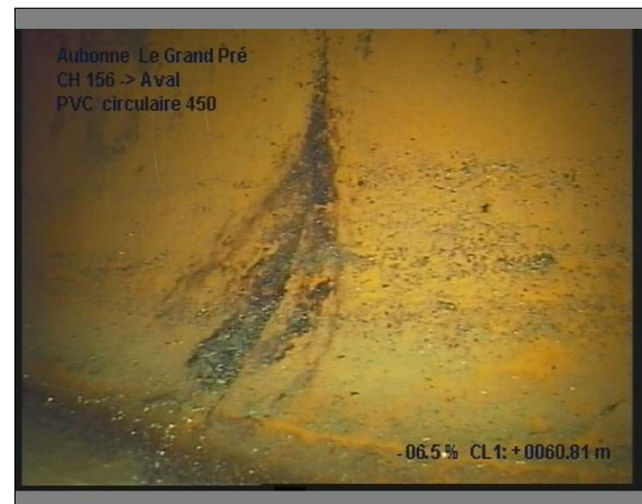
Photo: 1_17B, 00:07:44 60,5m, Liaison du tuyau non étanche de 08 à 04 h.
