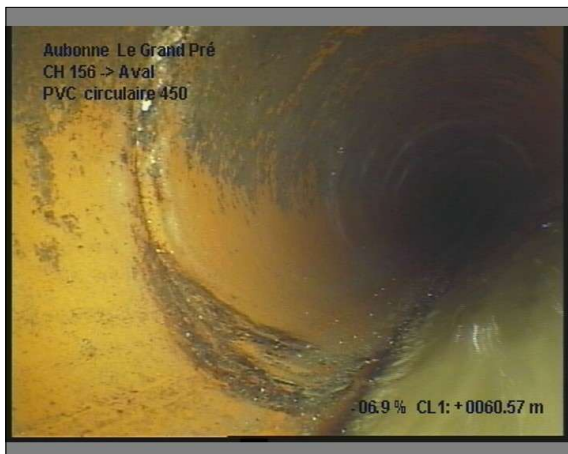
Photo: 1_17A, 00:07:44 60,5m, Liaison du tuyau non étanche de 08 à 04 h.
