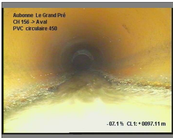
Photo: 1_29A, 00:12:57 97,1m, Cassure du tuyau de 12 à 12 h., Fin du dommage
