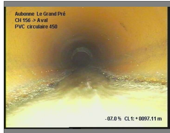
Photo: 1_28A, 00:12:49 96,6m, Fissure(s) à 12 h., Fin du dommage
