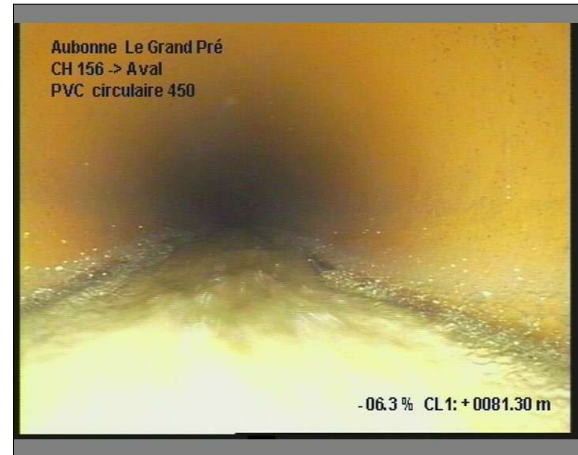
Photo: 1_24A, 00:10:40 81,3m, Fissure(s) à 12 h., Fin du dommage
