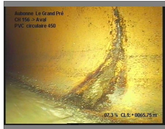
Photo: 1_18B, 00:08:24 65,6m, Liaison du tuyau non étanche de 12 à 12 h.
