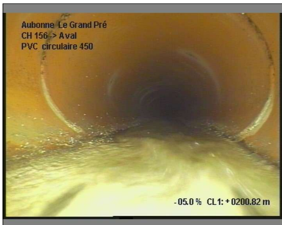
Photo: 1_35A, 00:20:51 200,8m, Liaison du tuyau non étanche de 12 à 12 h.
