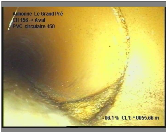
Photo: 1_15B, 00:07:01 55,6m, Liaison du tuyau non étanche de 12 à 12 h.
