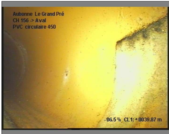
Photo: 1_10A, 00:05:19 39,8m, Cassure du tuyau de 12 à 12 h., Fin du dommage
