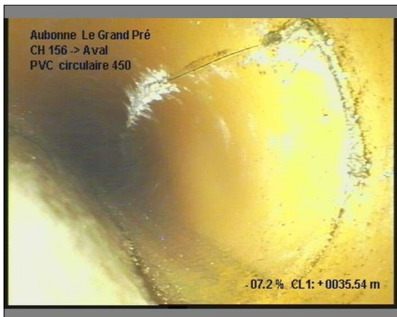
Photo: 1_8A, 00:04:42 35,5m, Cassure du tuyau de 12 à 12 h., Début du dommage
