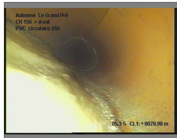
Photo: 1_22A, 00:10:14 78,9m, Cassure du tuyau de 12 à 12 h., Début du dommage
