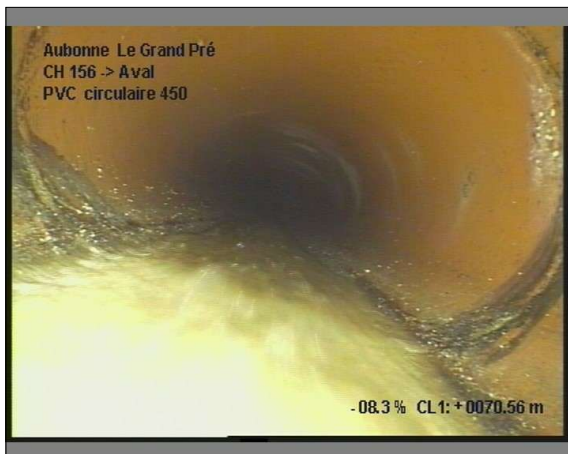
Photo: 1_19A, 00:09:00 70,5m, Liaison du tuyau non étanche de 12 à 12 h.
