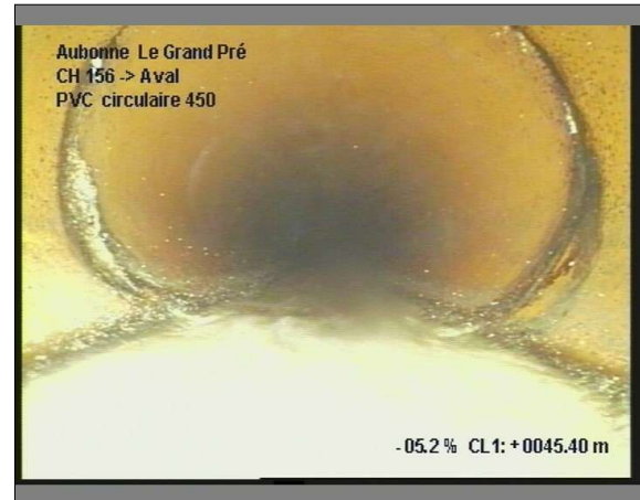
Photo: 1_11A, 00:05:43 45,4m, Liaison du tuyau non étanche de 12 à 12 h.
