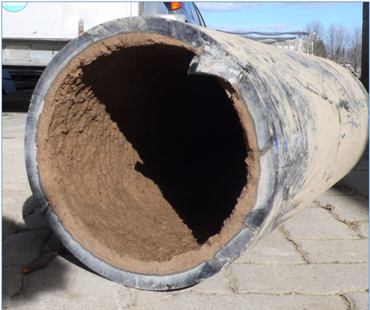
Figure 1: Tronçon de conduite découpé en 2010 pour créer une chambre de curage. Couche de calcaire après environ 3 ans d'exploitation
